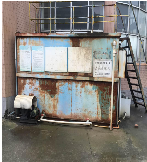
厂区废水处理设施
