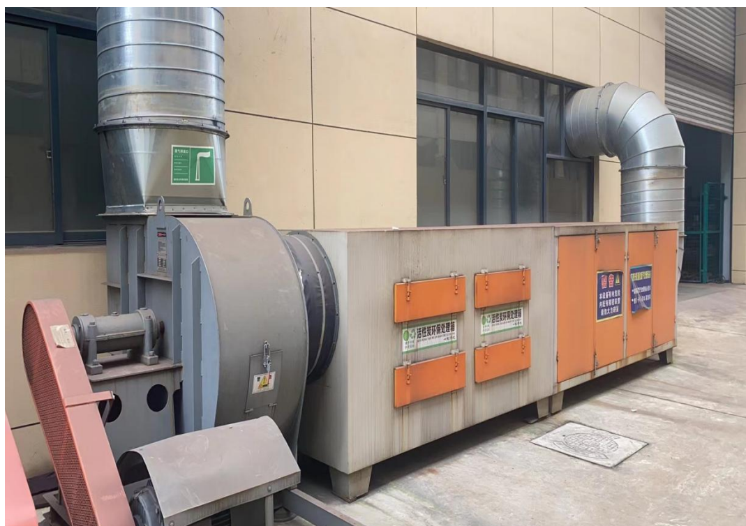
喷漆废气处理设施
