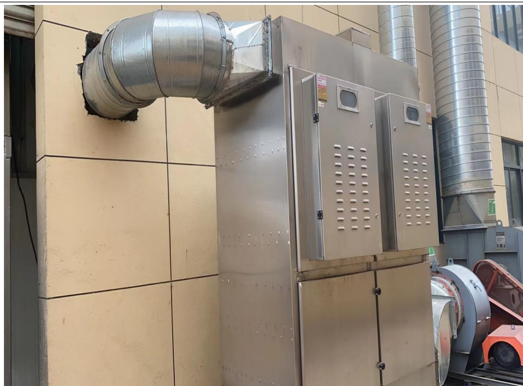
浸漆废气处理设施
