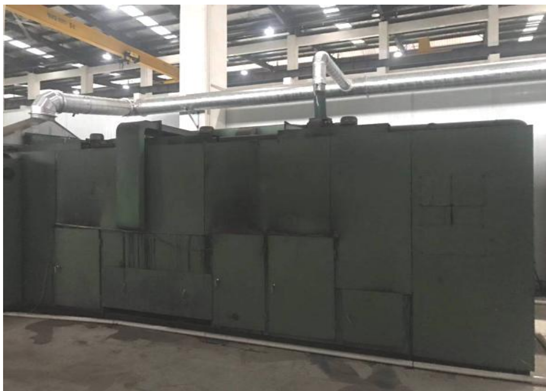
浸漆废气收集 1
