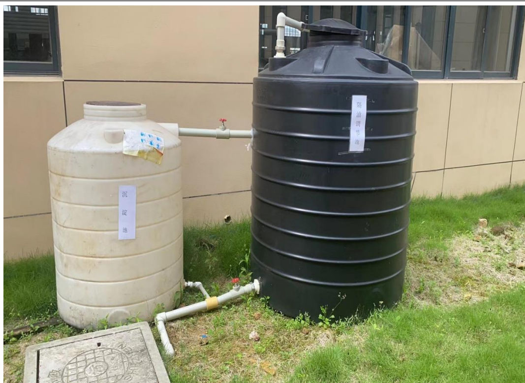
废水处理设施
