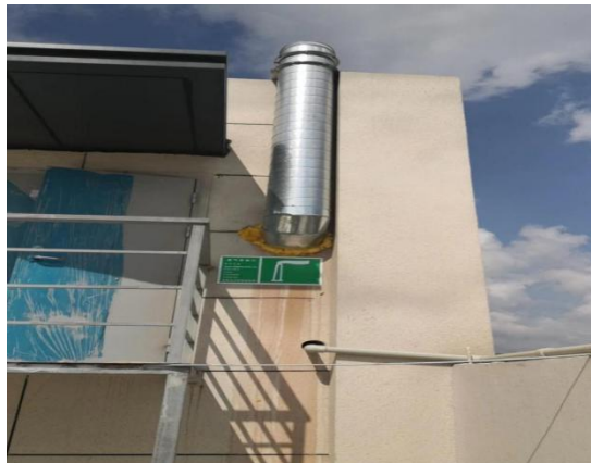
注塑废气排放口
